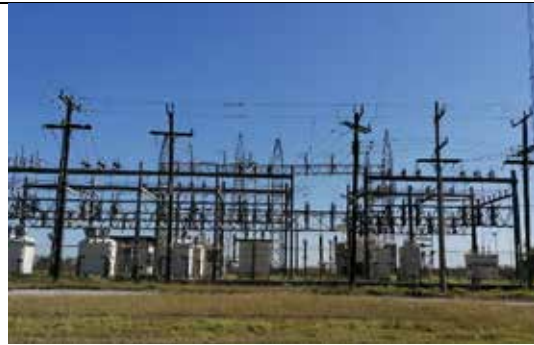
Ilustración 3. S. E. San Fernando
