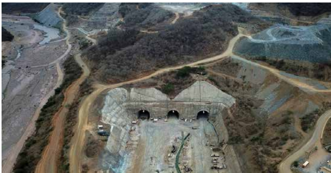
Fotografía: Portal de salida de los túneles de Desvío y Zona de Obras del E.H. de la Presa Sta. María.
