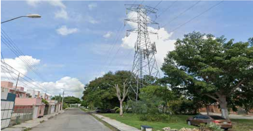
Fotografía (ilustrativa): Ejemplo de montaje de antenas de telecomunicación en torres de CFE
